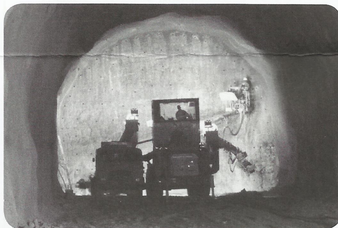
Front d'attaque sud, Choindez : la foreuse prépare une étape de minage en pleine section du tunnel.
