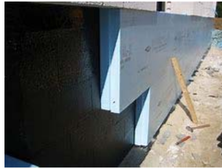
Isolation non minérale
