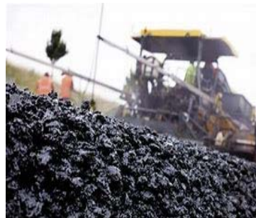
Matériaux bitumineux, max 250 mg/kg HAP jusqu'au 31.12.2027
